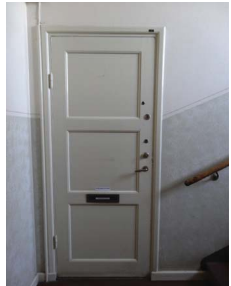
I det äldre lamellhuset hittas denna typ av spegeldörr med tre lika stora speglar som förekom omkring 1930. Dörrtypen finns även i radhusen och bör så långt det är möjligt bevaras. Funktionalismens helsläta dörrblad hade ännu inte kommit i bruk. Dörrfodren har slanka dimensioner. Om lägenhetsdörrar mot trapphus måste bytas ut bör man utgå från befintlig utformning.
