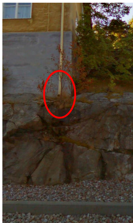
Figur 7. Ytlig avledning av takdagvatten i husets nordvästra hörn.
