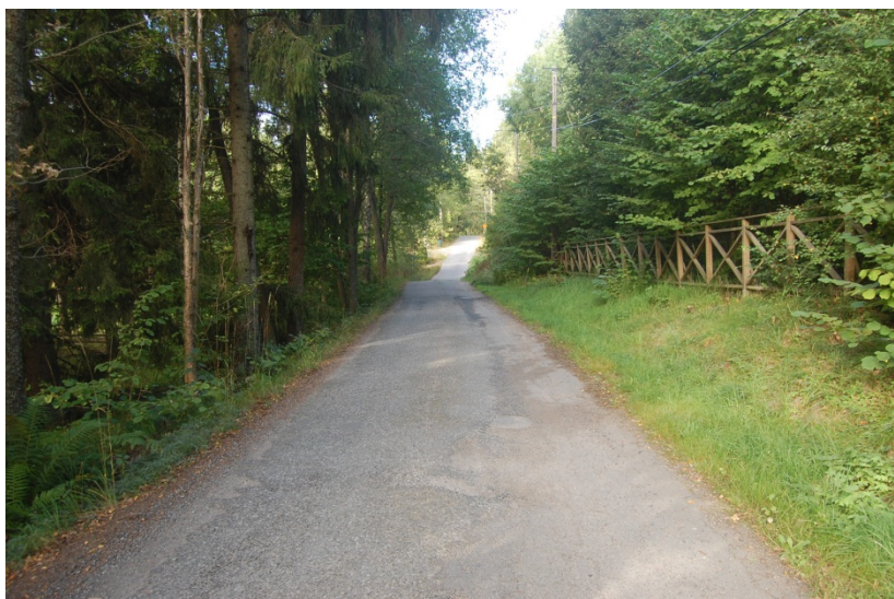
Foto 3. Vägavsnittets dagvatten leds till fastigheterna 14:44 och 14:45 till vänster i bild.
