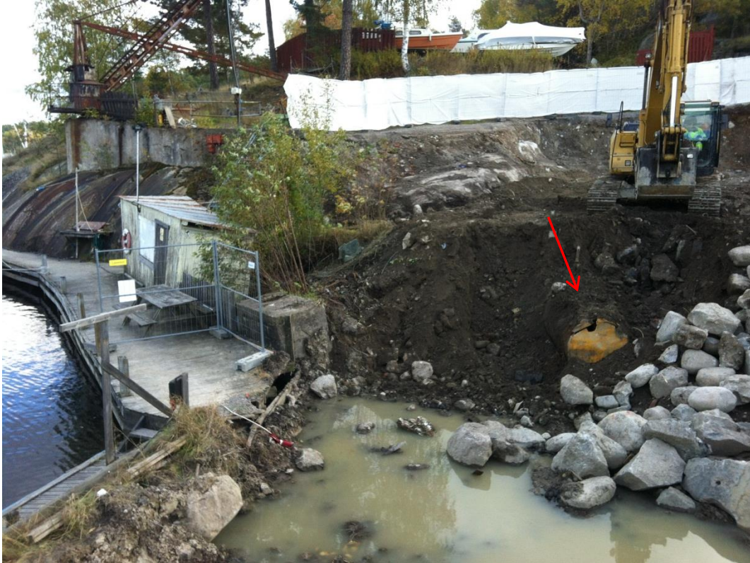
Foto 3: En 3 m 3 bensin cistern hittas mellan ruta 46 och 50, 2012-10-04
