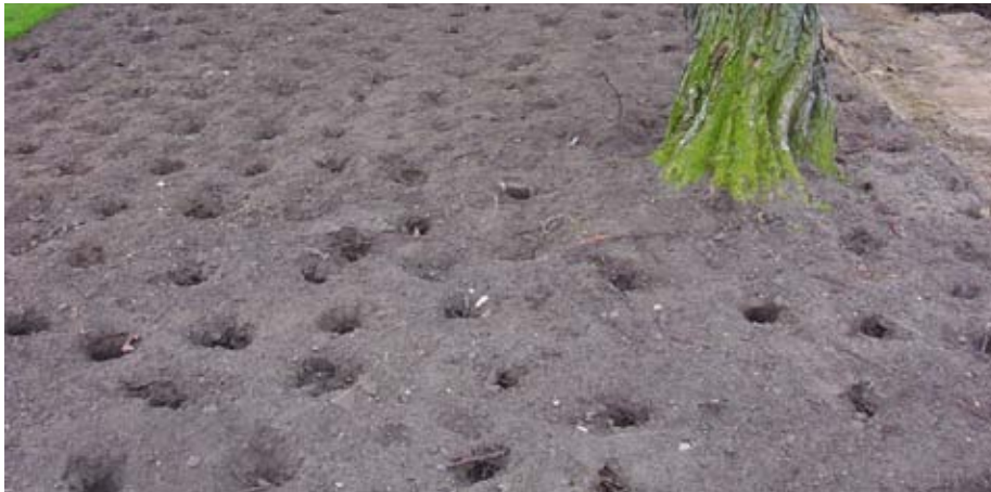
Tryckluftlans används dels för att skjuta loss jord vid rotvänlig schakt och dels för att luckra den gamla parkytan. Framschaktat rotsystem skyddas med utlagd växtjord. (Foto: Örjan Stål)
