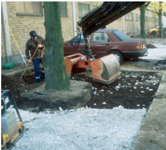
Färdigställande av parkering med luftig grusyta och låsande lager av makadam. (Foto: Örjan Stål)
