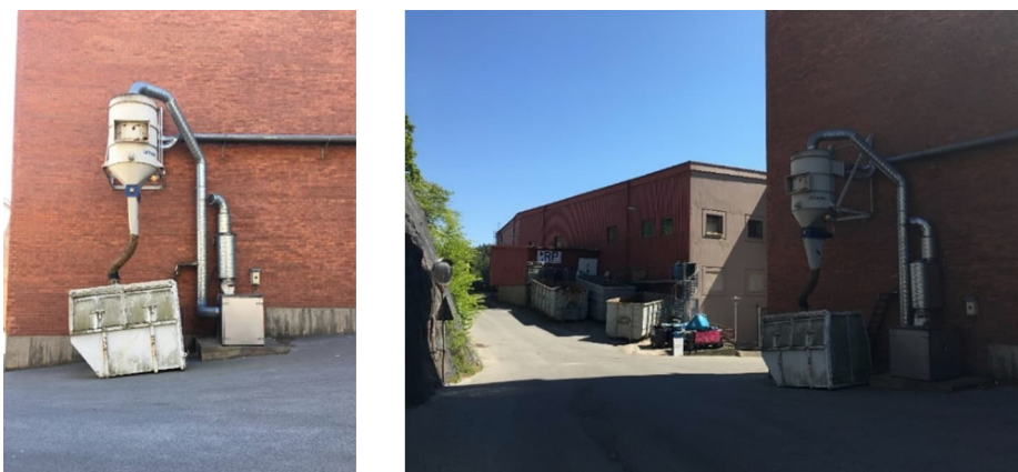
Figur 9. Cyklonrenare på fastigheten Sicklaön 37:49.
