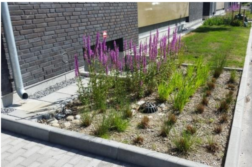
Figur 12 Växtbädd med inledning via stuprörsutkastar. Bräddning i form av kupolsil som kan avleda vatten då växtbädden är mättad (Nacka kommun, 2017).
