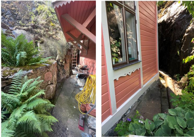
Figur 6: Dagvattensystemet invid huvudbyggnaden på fastigheten Björknäs 10:4.
