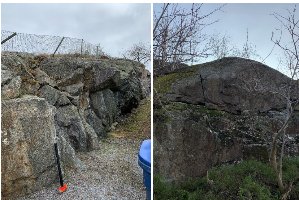
Figur 6: Till vänster: schaktad bergskärning vid Jakobdalsvägen, blockig till storblockig. Till höger: Naturlig bergskärning, mycket storblockig, sett från gångvägen i riktning mot söder.
