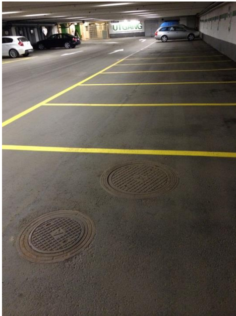
Figur 5 Tillsynsbrunnar i golvet på parkeringshus plan 3. Tillhör S300 under köryta.
