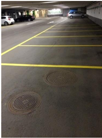
Figur 4 Tillsynsbrunnar på parallella S200 i närheten av förbindelsepunkt. Parkeringsgarage under Augustendalsvägen vån 3.
