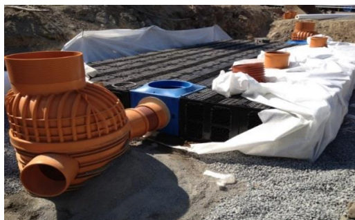
Fördröjningsmagasin av dagvattenkassetter.
