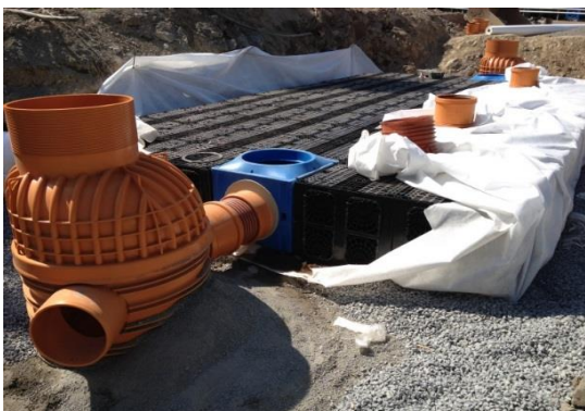
Fördröjningsmagasin av dagvattenkassetter.
