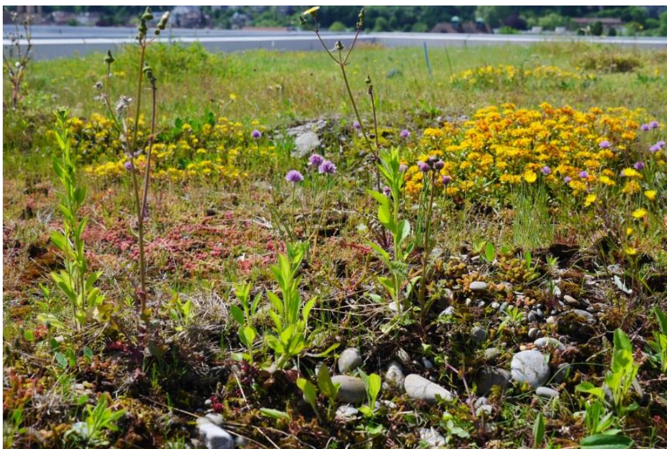
Figur 14. Exempel på ett anlagt grönt tak.
