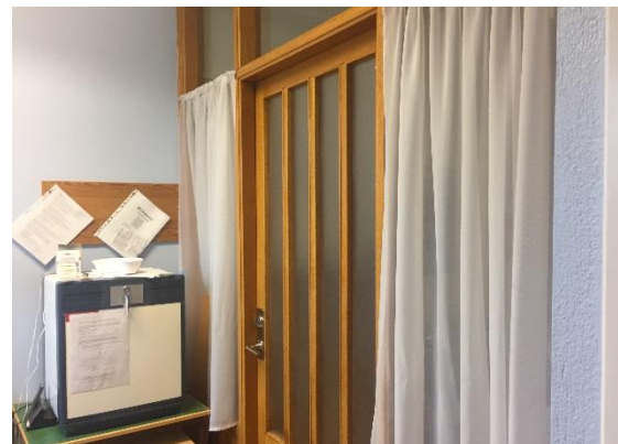
Bevarat glasat träparti i det som ursprungligen var skolsköterskans mottagningsrum. En detalj som ökar förståelsen för rummets specifika användning. Ett värdebärande karaktärsdrag.
