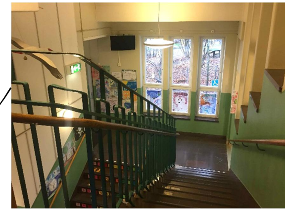
Trapphuset är välbevarat med ursprungligt kalkstensgolv, räcke och handledare liksom fönstren med fönsterbänkar av kalksten. Värdebärande karaktärsdrag .
