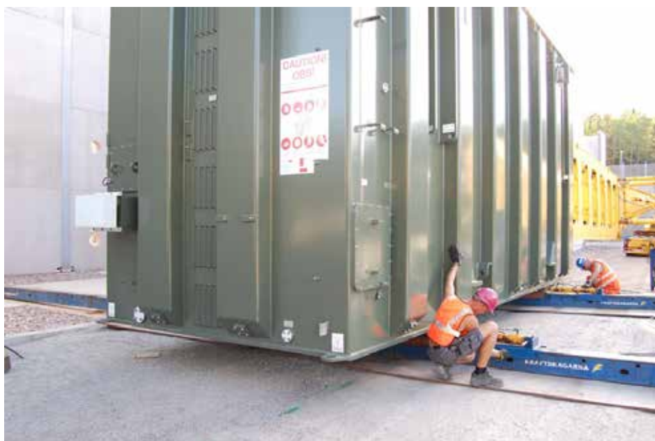
Precis avlastad krafttransformator utan tillbehör (genomföringar, fläktar, expansionskärl mm).
