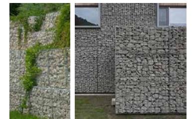
Referens stödmurar / fasadbeklädnad i gabion.
