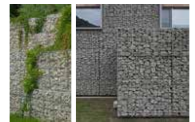
Referens stödmurar / fasadbeklädnad i gabion.
