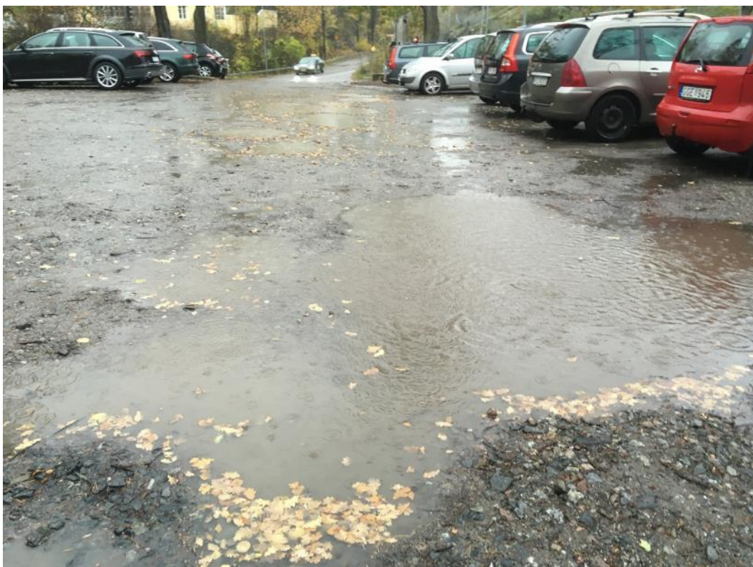
Figur 10. Befintlig grusparkering bedöms ha låg infiltrationskapacitet. Vid kraftig nederbörd såsom på bilden finns idag inte tillräcklig infiltrationskapacitet.
