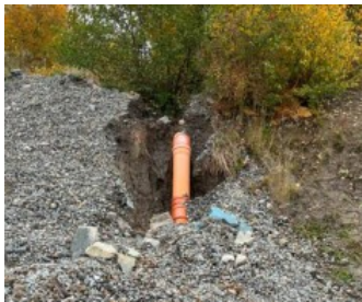
Figur 21: Erosion kring en ledning öster om område 2, (Tyréns, 2025).
