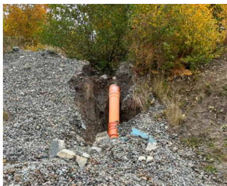
Figur 18. Erosion längs med sluttningen i högra hörnet av Tomt 2. Noterad under platsbesöket den 2024-10-11.
