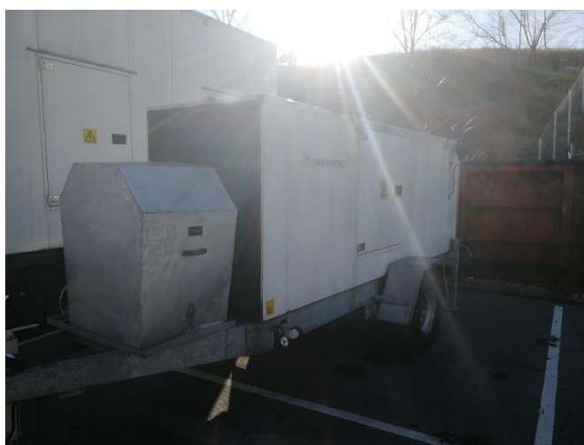
Figur 2: Vagnen med det mindre reservkraftaggregatet längst fram och den större modellen bakom denna.
