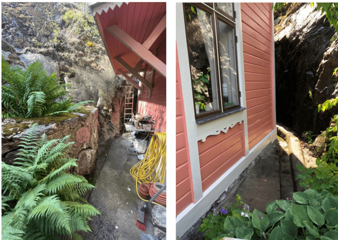
Figur 6: Dagvattensystemet invid huvudbyggnaden på fastigheten Björknäs 10:4.
