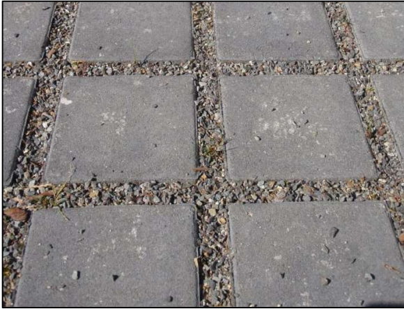
Figur 5-4. Exempel på genomsläpplig betongbeläggning med grusfogar. (VA-guiden, 2020)
