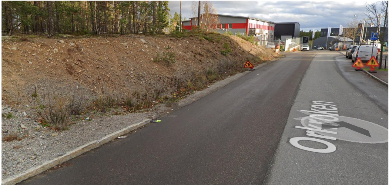
Figur 4, ca 3 m hög jordskärning utan erosionsskador trots brist på växtlighet, vy mot Örkroken 8. Obs, dike saknas. (bild: Google gatuvy 2022)
