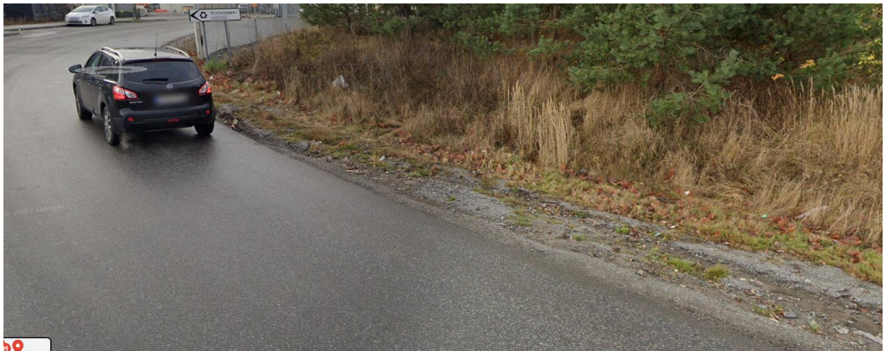
Figur 5, vy mot syd (Örkroken 4 på höger sida bilden) med erosionsspår från dagvatten som rinner utan dike längs norra sidan av gatan. (bild: Google gatuvy 2022)
