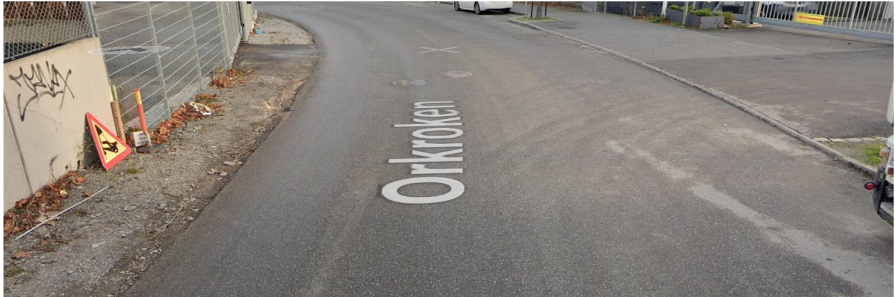
Figur 6, vy mot norr med Örkroken 4 på vänster sidan bilden med erosionsspår från dagvatten som rinner utan dike längs norra sidan av gatan. (bild: Google gatuvy 2022)
