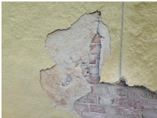
Frostskada som visar gammalt originalpusskikt och hur lisenerna endast består av puts, utan förtagning i teglet
