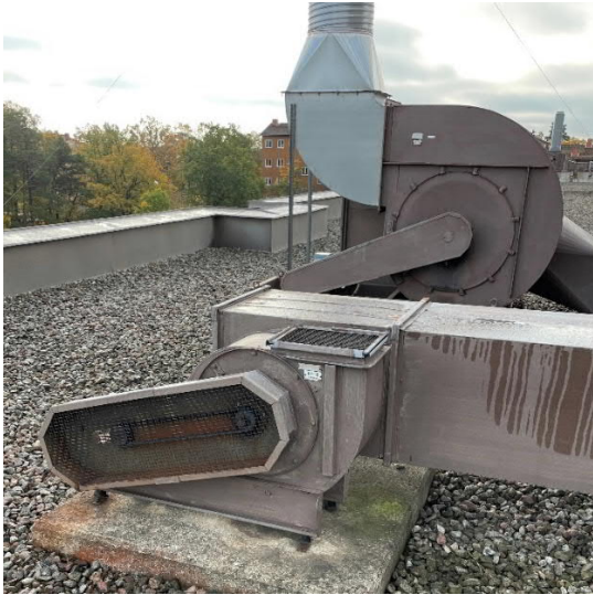
Figur 11. Ljudkällor i behov av åtgärd.
