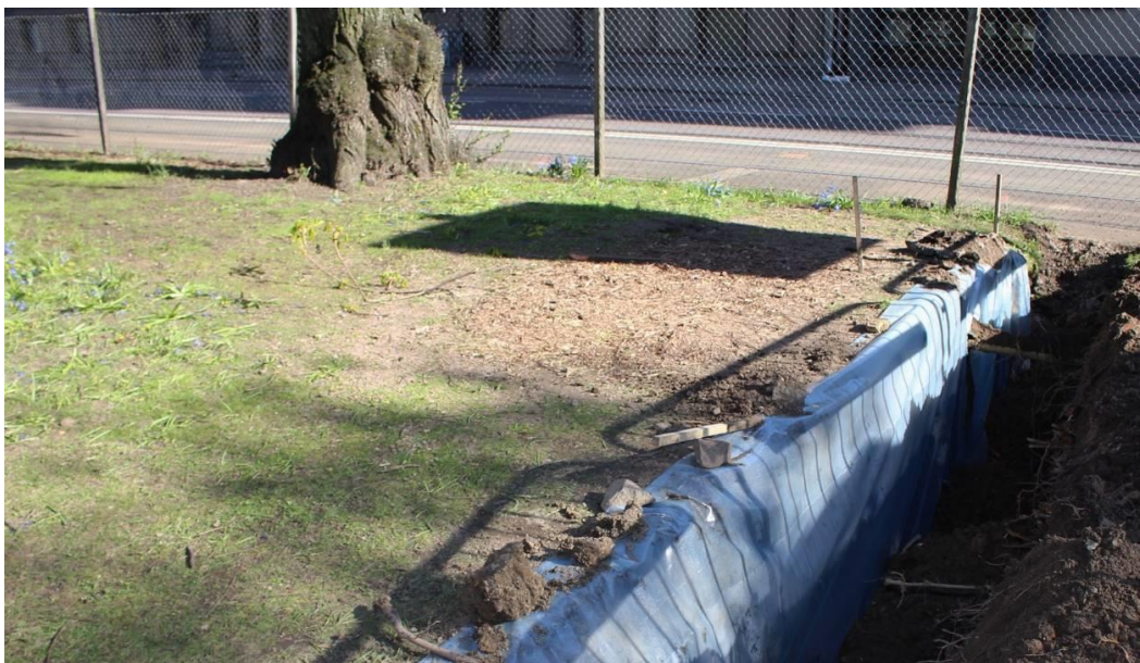
Bild 6. Rotdraperi av plast vid schaktvägg för att motverka uttorkning av jord och beskurna rötter.
