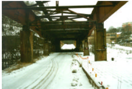
Den östra kranbanan
