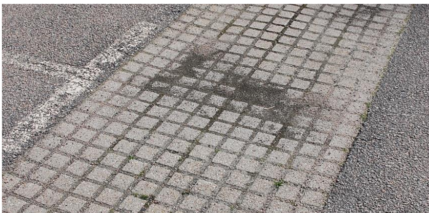
Figur 18 Genomsläpplig beläggning i form av stenplattor med avstånd mellan plattorna. Bilden visar också på hur hålrummen kan sättas igen med partiklar (Sweco).
