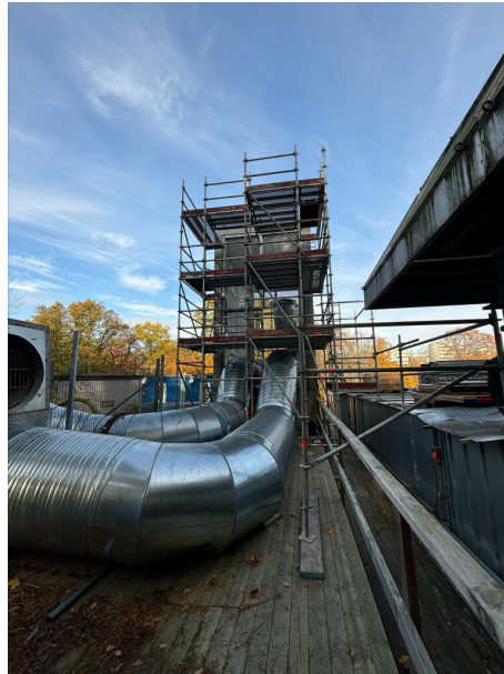
Figur 4 Tillfälliga avluftskanaler dras via ventilationstornet, utsida torn.
