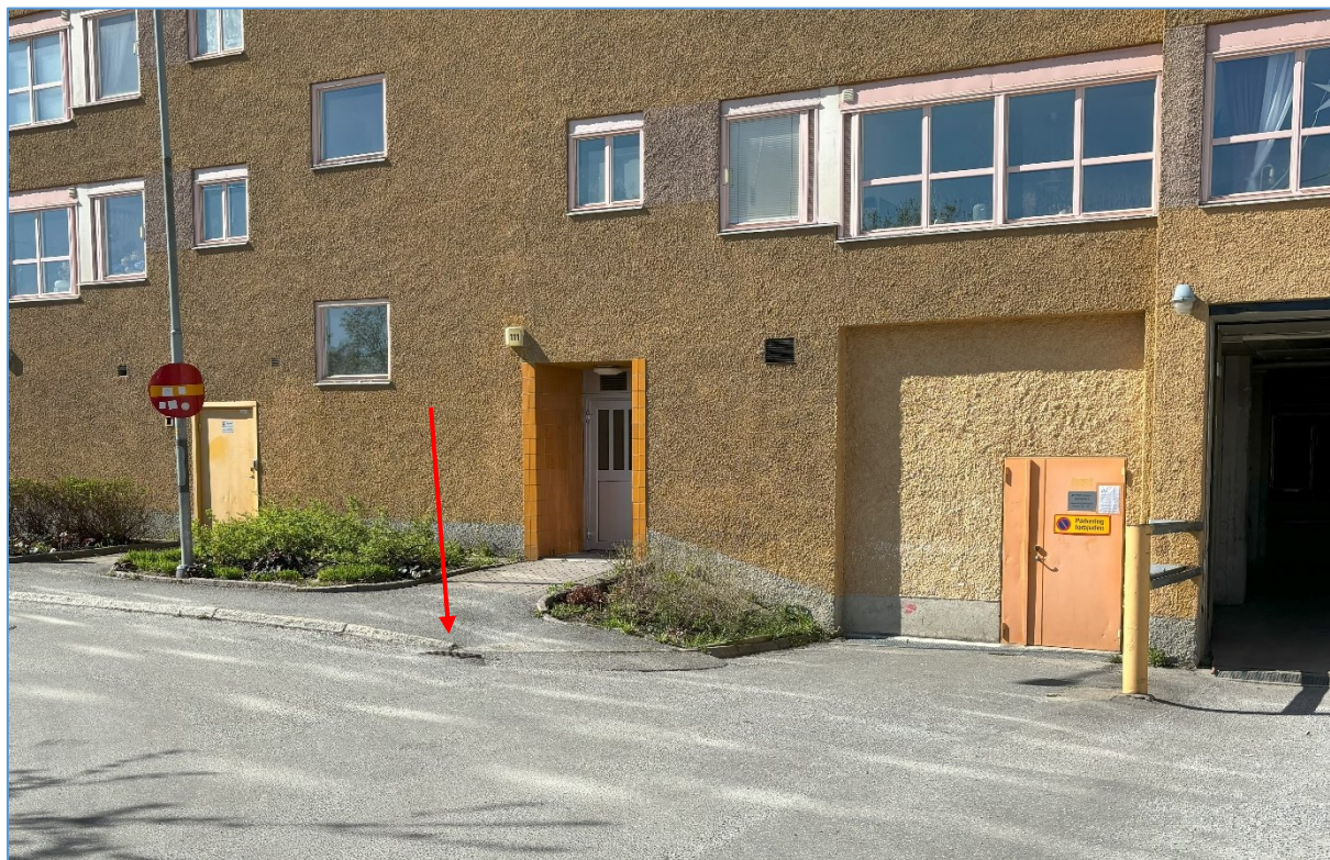
Figur 2-9. Exempel på dagvattenbrunn där inflöde kan försvåras på grund av upphöjningar kring brunnen samt höjdsättning av brunnen. Foto från platsbesök 2024-05-07.
