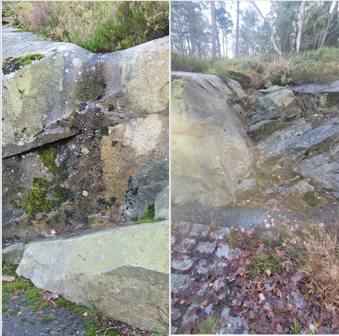
bilaga - Foto platsbesök (2022-11-10): Läckande vatten mot Fabrikörsvägen
