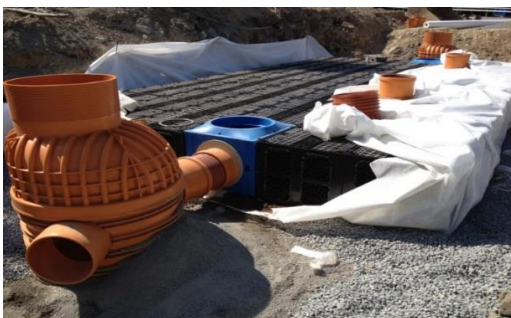
Fördröjningsmagasin av dagvattenkassetter.
