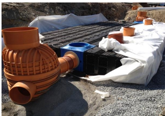
Fördröjningsmagasin av dagvattenkassetter.
