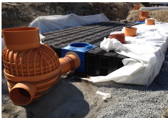
Fördröjningsmagasin av dagvattenkassetter.
