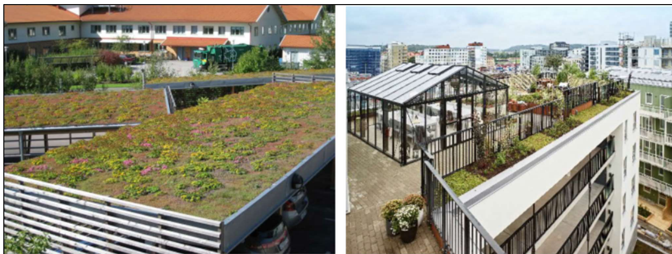
Figur 19. Grönt sedumtak på garagebyggnad, samt bostadshus med gröna inslag på takterrass. Bildkälla: VegTech AB samt Veidikke AB.
