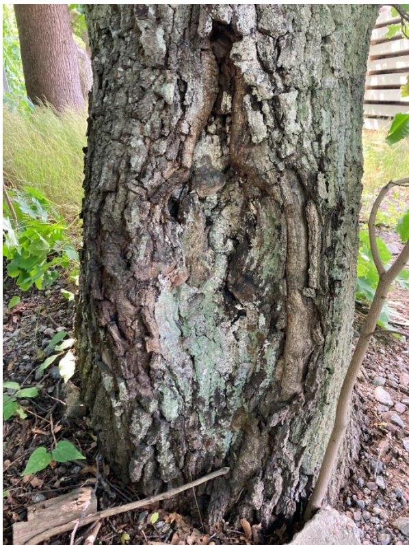
Foto 16. Träd 2.1 med stor stambasskada.
