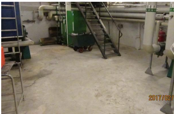
Bild 9. Inre delen av pannrummet. Pelletspanna skymtar till vänster.
