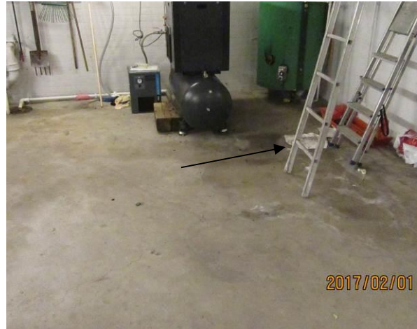
Bild 8. Tvätthall inredelen av golvet. 17W63B vid pilen, Synliga föroreningar på golvet.
