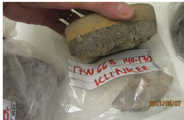
Bild 10. I panncentral är betonggolvgjutet ca 150 mm ovanpå det gamla klinkergolvet. 17W66B
