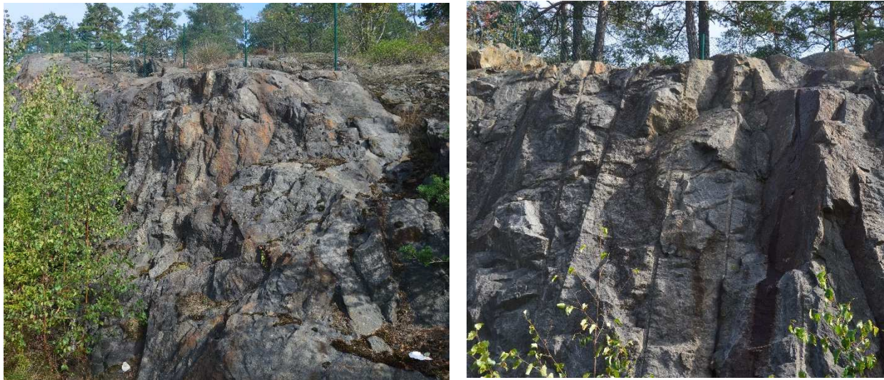
Figur 6-4. Skärning i södra delen av Ormingeleden. Tydlig rostbildning på sprickytor.
