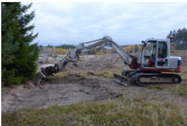
Figur 1. Bilden visar ett tidigt stadium i arbetet med anläggandet av övervintringsplatsen vid Molnby. Först grävdes en grop på omkring 4x3x0,8 meter.
