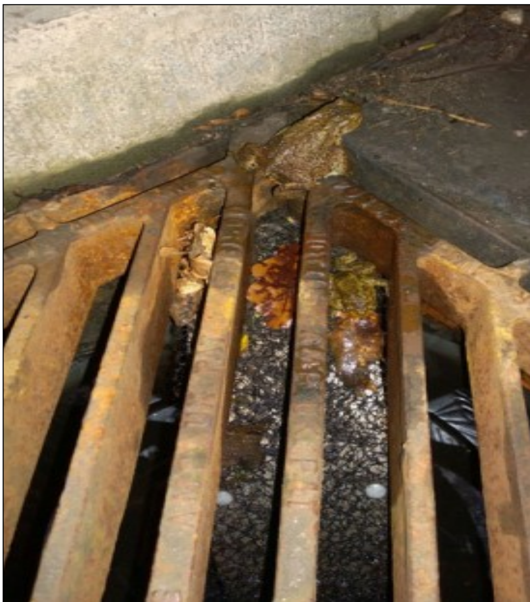
Figur 1. I denna dagvattenbrunn har en groddjursstege installerats vilken gör det möjligt för paddor som ramlat ner att klättra ur.
