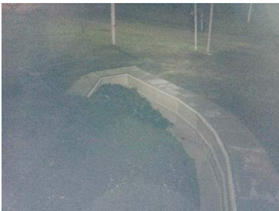
Figur 13. Barriär vid Spångavägen. Anläggningen är byggd med prefabricerade block från ACO system för amfibietunnlar. Här visas änden av barriären där en "krok" anlagts för att öka chansen att groddjuren går mot passagen istället för åt fel håll. Foto: Anna Koffman.
