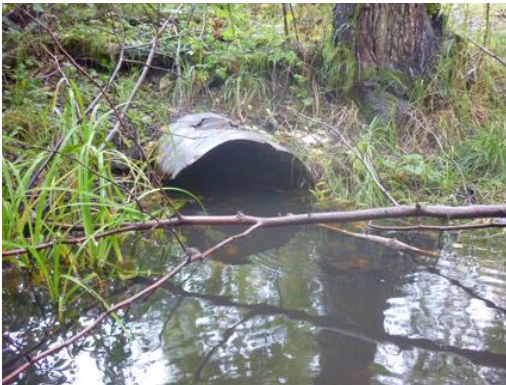
Figur 4. Vägtrumma i korrugerad plåt mellan våtmarksområdet och Sarvträsk. Trumman står delvis dämnd. Bild tagen från våtmarksområdet. Foto: WRS.
