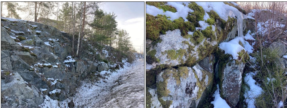
Figur 5-4. Exempel på karterade berghällar längs Skarpövägen (t.v., foto nr. 1) samt uppsprucken håll vid slutningen (t.h., foto nr. 2).
