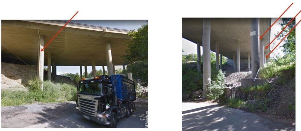
Figur 23 Stuprör från väg 222 som ser ut att släppas direkt på marken. Här finns stor potential att avskilja föroreningar för att förbättra kvaliteten på del av det vägdagvatten som når Strömmen samt kompensera för ökad föroreningsbelastning från DP Ryssbergen.
