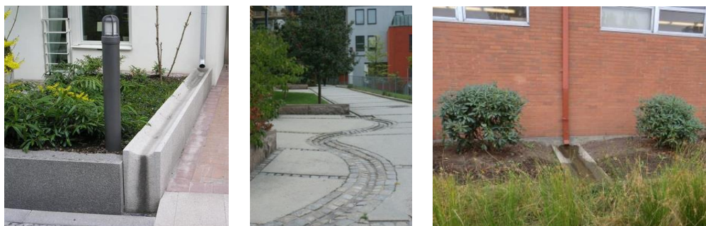
Figur 9. Bilderna ger exempel på stuprörsutkastare som ansluter till rännor samt olika typer av rännor.
