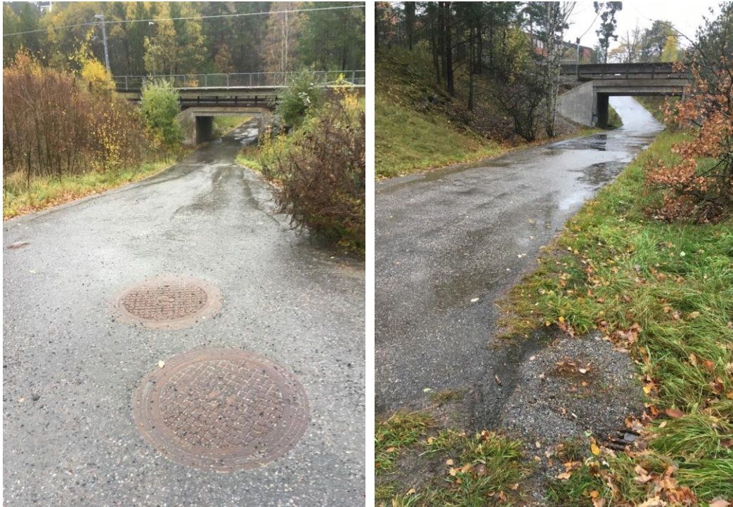
Figur 14. T.vä vy mot viadukt från söder mot norr. T.hö vy mot viadukt från norr mot söder med befintlig dagvattenbrunn i förgrund.
