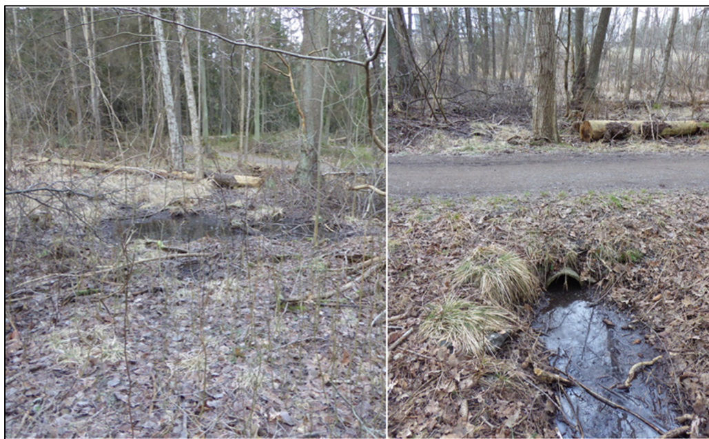
Figur 4. Lågpunkt inom planområdet (bild till vänster) och en vägtrumma som avleder vattnet från lågpunkten (bild till höger). Foto: WRS (200204).
