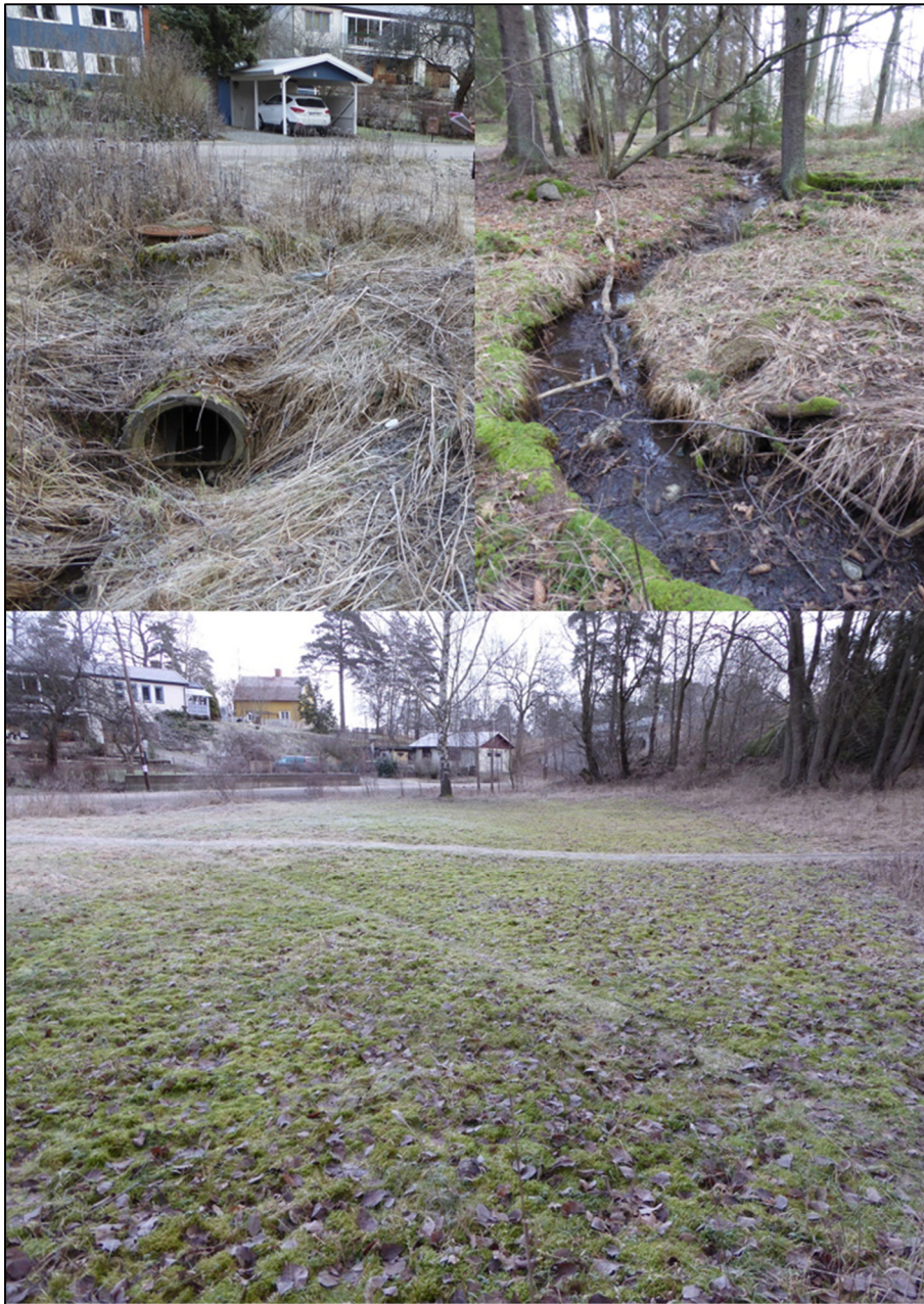
Figur 5. Befintligt dike (övre bild till höger), ledning som ansluter till ledningsnätet (övre bild till vänster) och lågpunkt vid Bråvallavägen (nedre bild). Foto: WRS (200204).
