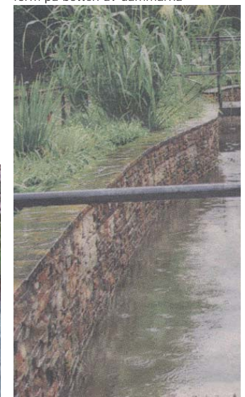
Tegel från bruket kan användas som stödmur mot vattenytan eller i korsad form på botten av dammarna
